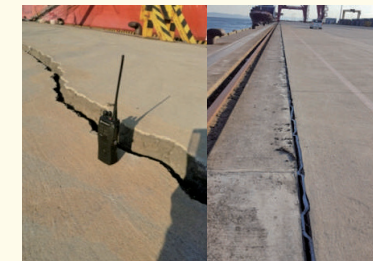
• 영일만 부두 지반 균열
