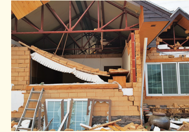
• 장량동 주택 외벽 파손
