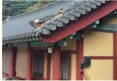
• 불국사 지붕 기와 파손
