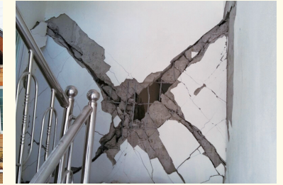
• 장량동 기예공 주택 내벽 파손
