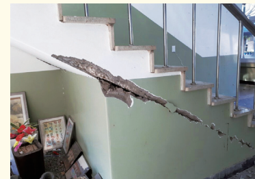
• 포항흥해공고 계단 균열
