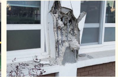
• 흥해초등학교 건물 기둥 파손
