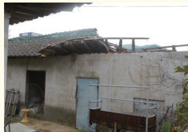
• 창고 지붕 파손
