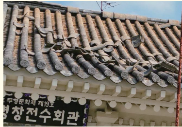
• 무형문화재 전수관 지붕 기와 파손
