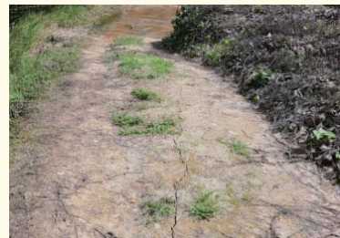
• 사곡지 저수지 둑 균열
