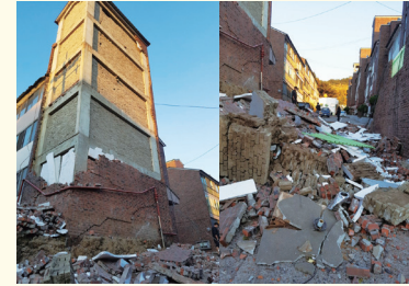
• 환여동 대동빌라 외벽 탈락
