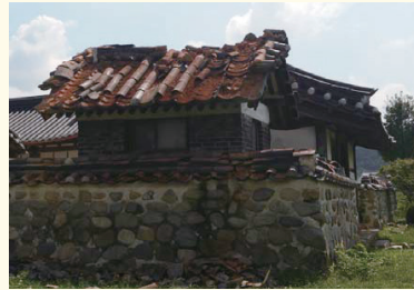
• 사마소 지붕 기와 파손
