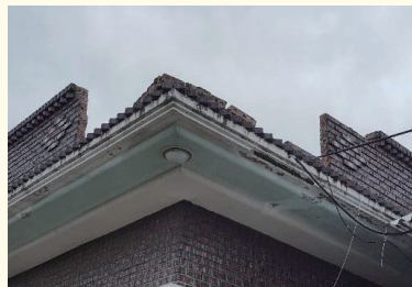
• 주택 지붕 난간 파손
