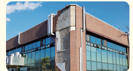
건물 외벽 탈락
