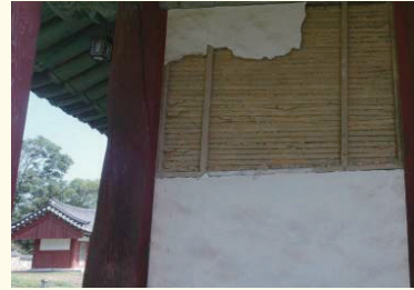
• 경주 향교 벽체 파손
