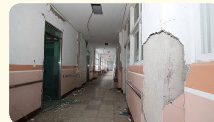
건물 내부 벽체 파손
